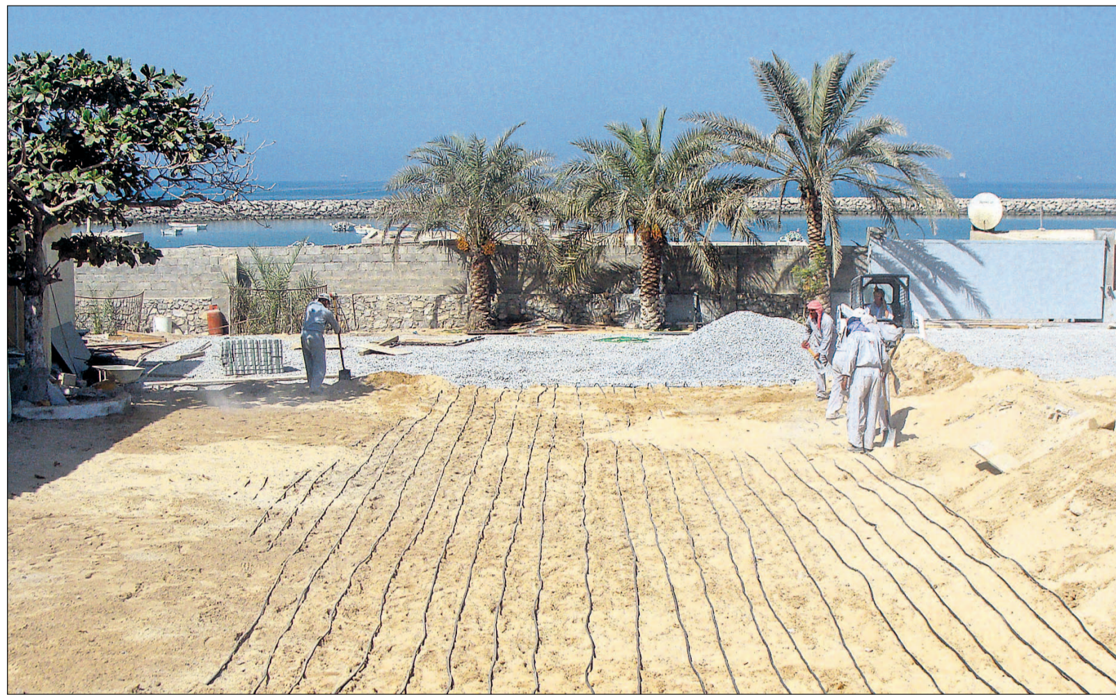
Vor allem in sandiger Erde – wie hier in den Vereinigten Arabischen Emiraten – ist die Unterflurbewässerung in Verbindung mit Feuchtheitspeichern unerlässlich: Ein Tonmineral um den Schlauch hilft, Wasser zu sparen, und es verbessert die Bodenqualität. Fotos: Hydrip
